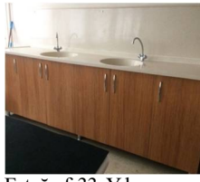
Fotoğraf 33. Yıkama ve Durulama Alanı
